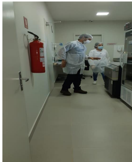
Avaliação de Rede Elétrica
