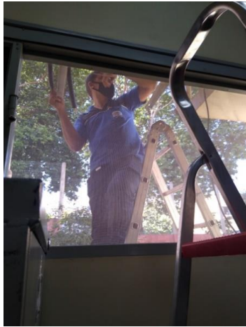
Manutenção de ar condicionado
