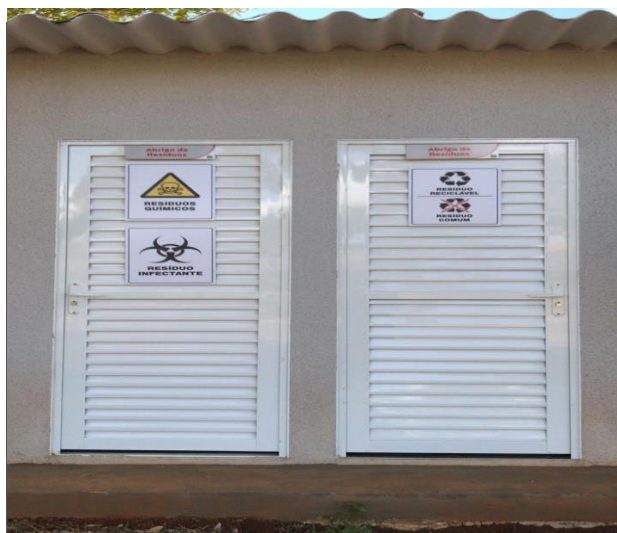
Identificação Abrigo de Resíduos Formosa
